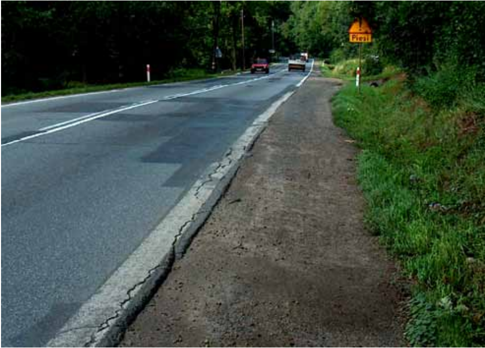
Fot. 25. Osuwisko nr 14 w Myślenicach. Osuwanie się warstw gruntu (prawa strona zdjęcia) w kierunku drogi po zabezpieczeniu osuwiska sprzed prawie 80 lat. Do czasu przebudowy DK 7 na S7 osuwisko skutkowało jedynie niewielką deformacją nawierzchni na długości ok. 20 m i deformacją pobocza ziemnego. Obecnie droga została całkowicie przebudowana na drogę ekspresową nr S7
