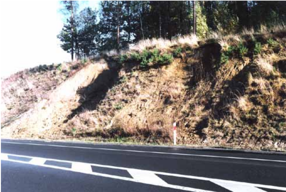
Fot. 5. Widok osuwiska skarpy drogowej na obwodnicy Zielonej Góry
