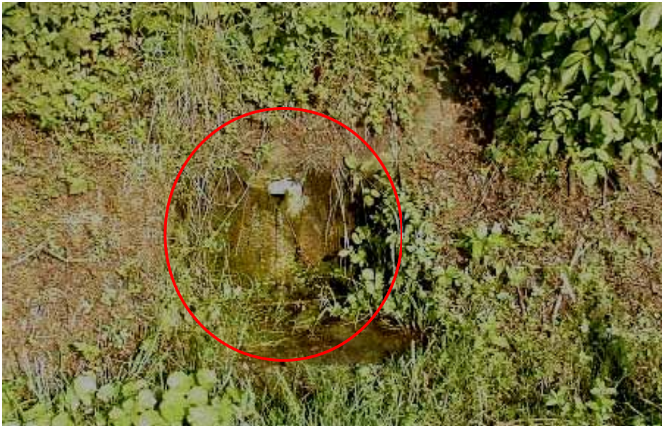
Fot. 1. Wylot sączka skarpowego do rowu odwadniającego. Urządzenie pracowało bez zastrzeżeń mimo upływu czasu, widoczny ciągły wysięk wody ze zbocza. Km 701+050, strona prawa drogi, miejscowość Stróża
