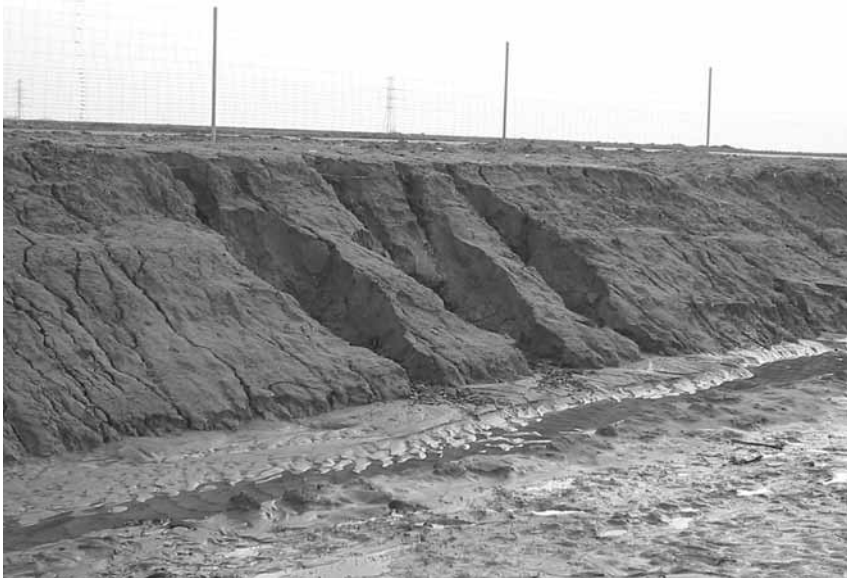
Fot. 7, 8. Rozmycia erozyjne - Autostrada A4
