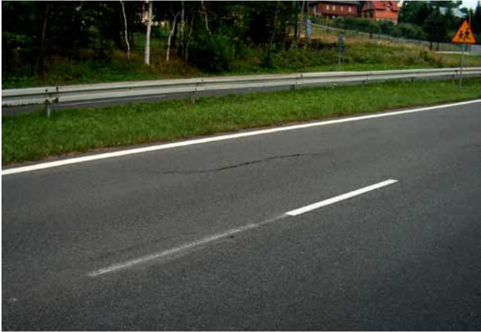
Fot. 16. Nowe pęknięcie po kilkudniowych opadach deszczu w lipcu 2003 roku
