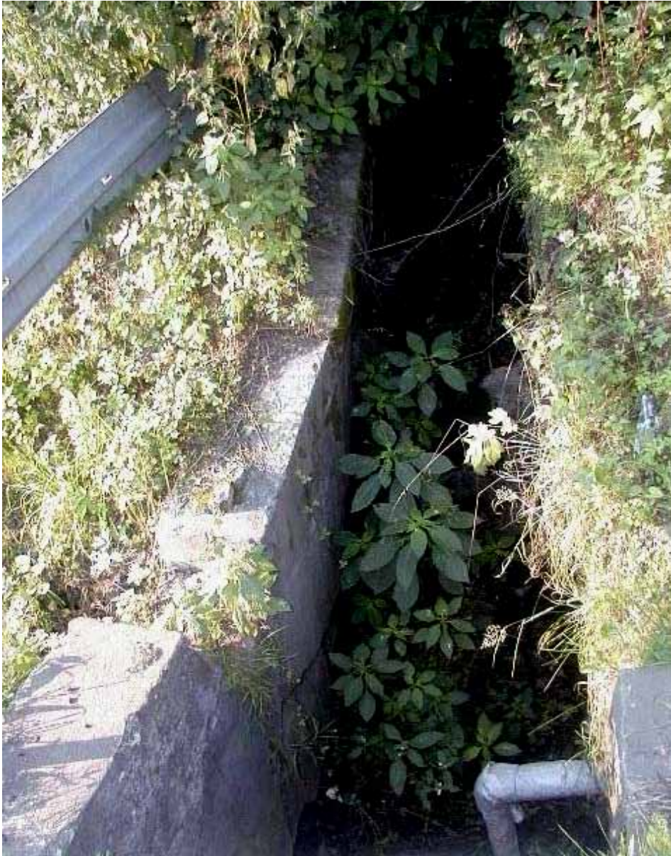
Fot. 4. Po prawej stronie muru oporowego w Stróży znajduje się studnia wpadowa dla wody opadowej z drogi. Mając po lewej stronie zbocze góry wykazującej tendencje do osuwania się, zabezpieczono studnię murem betonowym, który po tylu latach uległ stopniowemu spękaniu u podstawy (widocznej nad gruntem) i łukowatemu przemieszczeniu w prawą stronę na wskutek parcia gruntu. Km 703+420, strona prawa drogi, miejscowość Stróża
