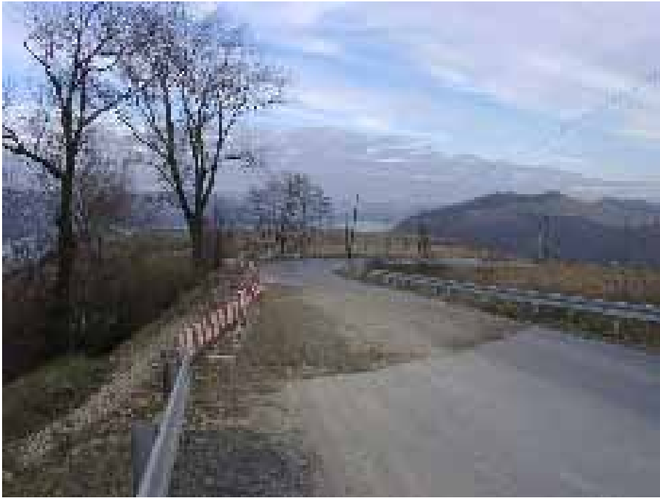
Fot. 7. Widok uszkodzeń w nawierzchni drogowej i skarpie nasypu, po tymczasowym zabiegu zabezpieczającym
