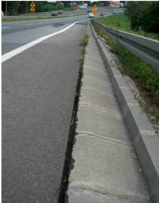
Fot. 10. Widoczna szczelina przy krawędzi pobocza bitumicznego
