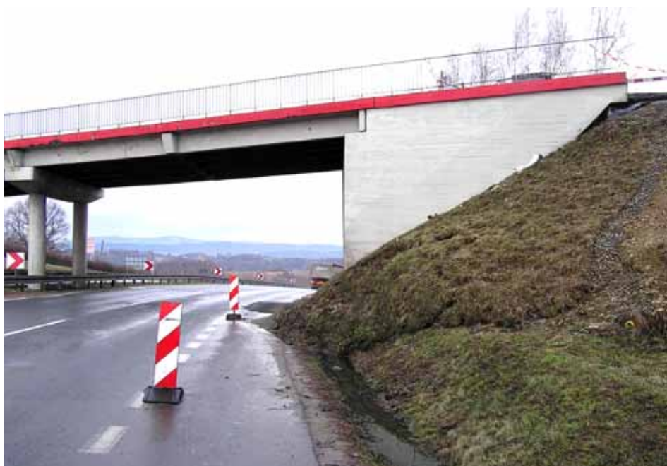
Fot. 31. Spływ stożka wiaduktu na węźle w Mogilanach przy prawej jezdni DK 7 (kwiecień 2006r.)
