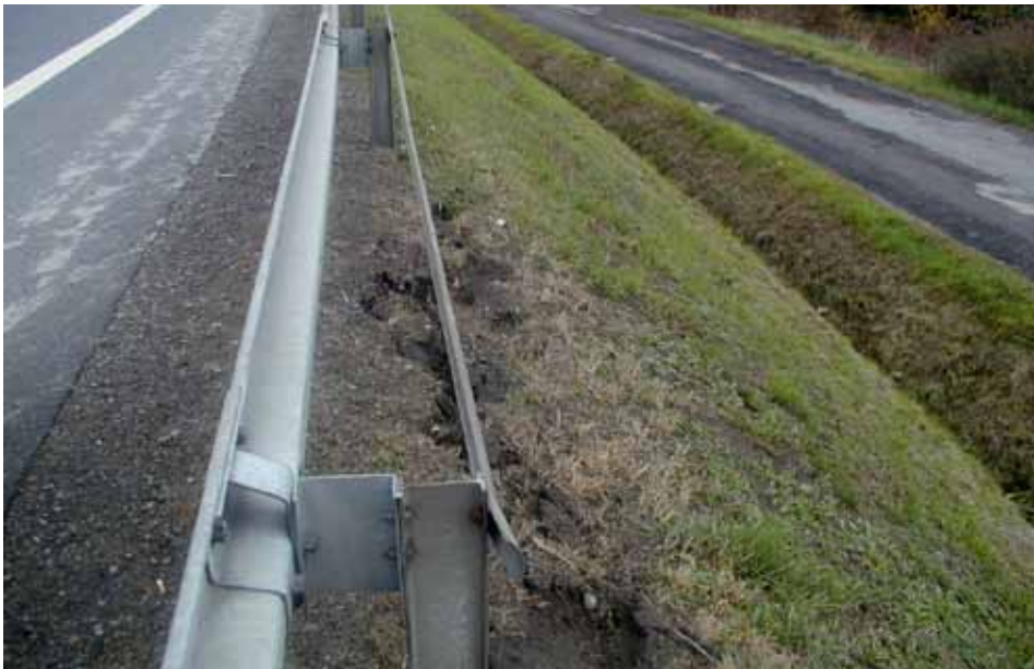
Fot. 17. Pęknięte południowe pobocze gruntowe po sezonie zimowym 2006/2007 na osuwisku „Mogilany III”
