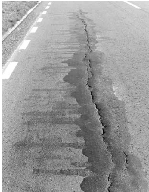
Fot. 1. Pęknięcie podłużne nawierzchni na skutek nierównomiernego osiadania nasypu drogowego
