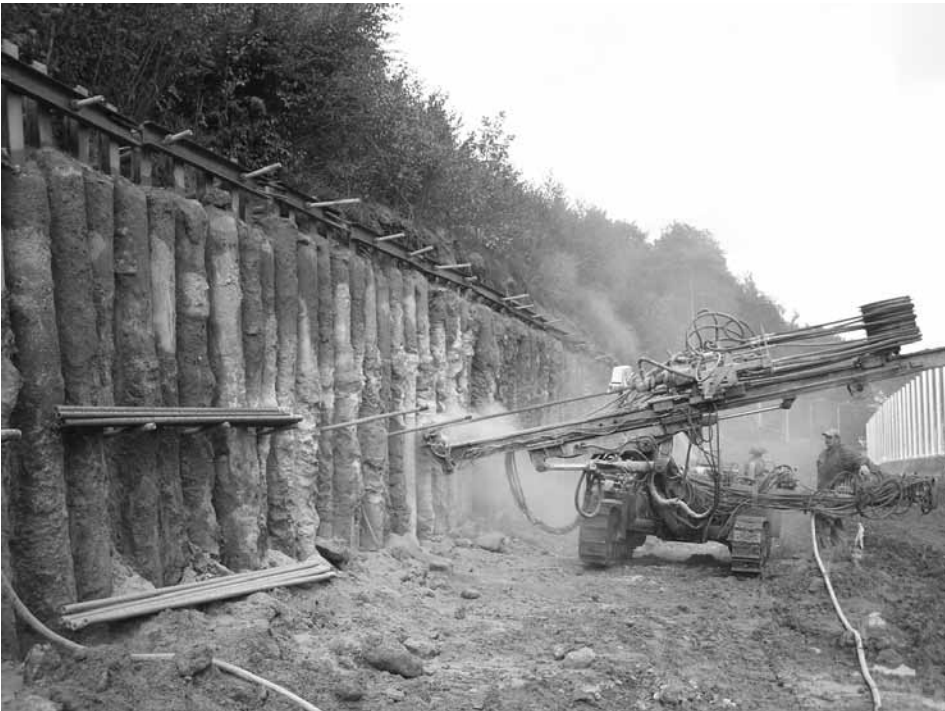
Fot. 1. Palisada z pali DFF kotwiona 2 rzędami mikropalami kotwiących TITAN 40/16 - budowa muru oporowego w zadaniu „Rozbudowa drogi krajowej Nr 7 Kraków – Chyżne na drogę ekspresową Nr S-7 na odcinku Myślenice – Pcim”
