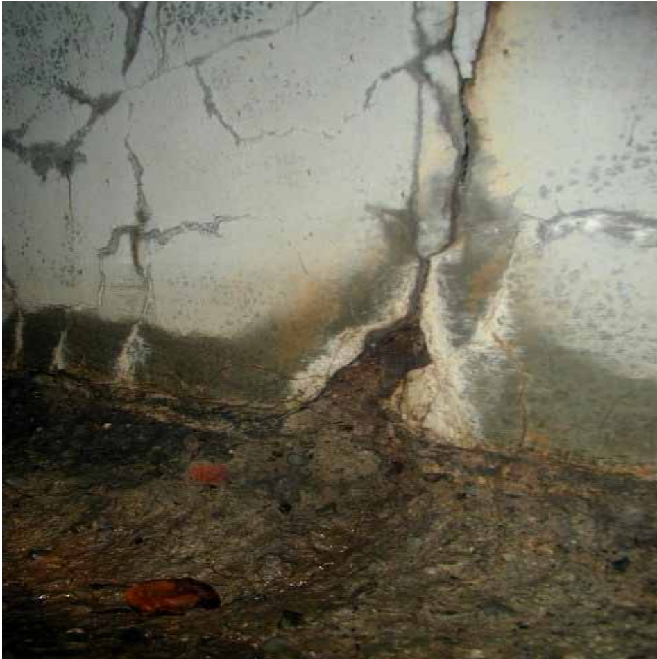
Fot. 12. Wyraźne pęknięcie w ścianie bocznej przepustu sklepionego i widoczny materiał z nasypu przedostający się do środka przepustu
