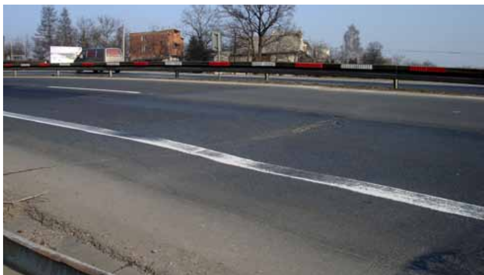
Fot. 19. Zdeformowana nawierzchnia na osuwisku „Mogilany III” (marzec 2007r.)
