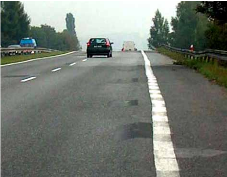
Fot. 7. Osuwisko nr 1 w Libertowie, widoczna deformacja nawierzchni i obniżenie w stronę pobocza; ugięte bariery sprężyste (stan przed ostatnią przebudową)
