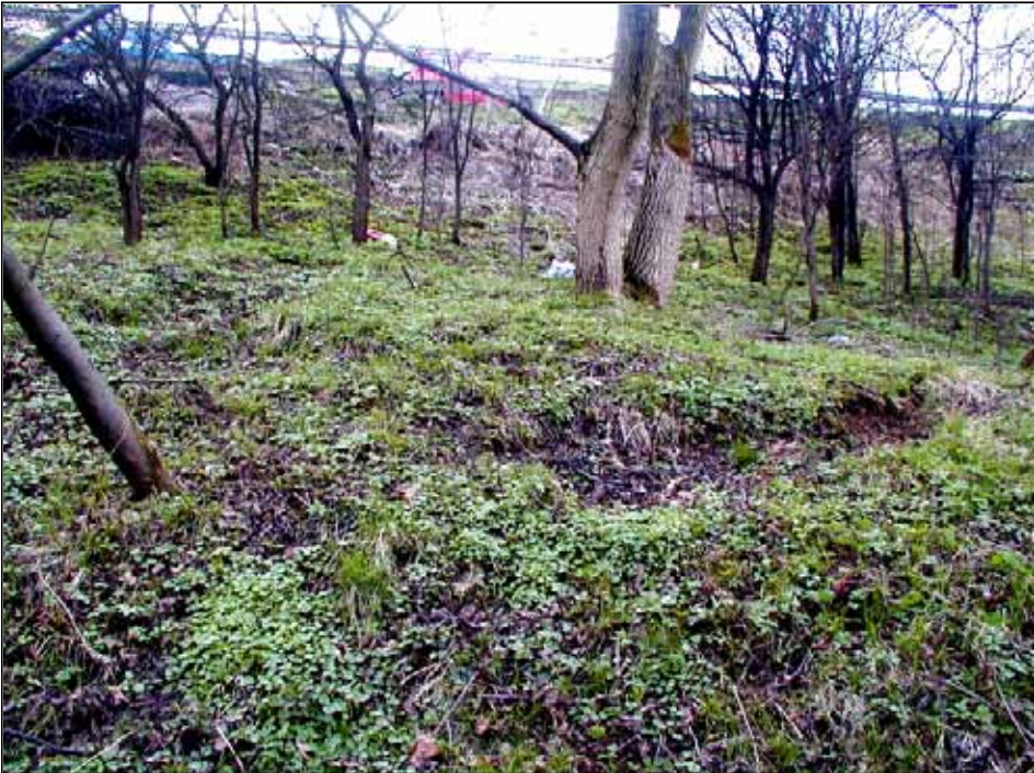
Fot. 11. Skarpa zdeformowana w wyniku przechodzenia bocznej linii osuwiska (drzewa pochylone w kierunku przeciwnym do przemieszczeń warstw gruntowych), widoczne obrywy gruntu
