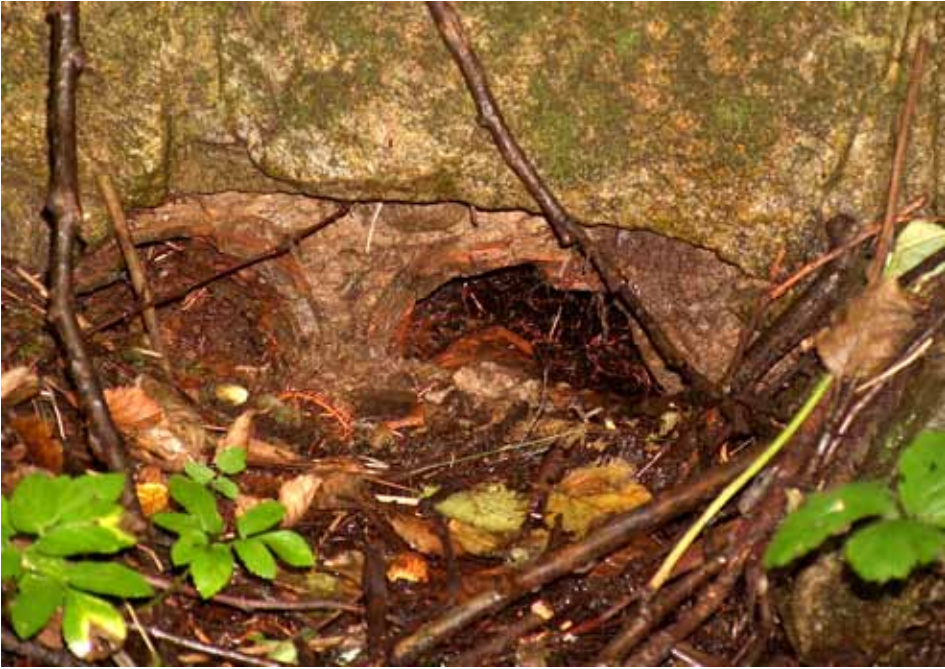
Fot. 9. Wylot drenu skarpowego (woda ciągle się sączy)
