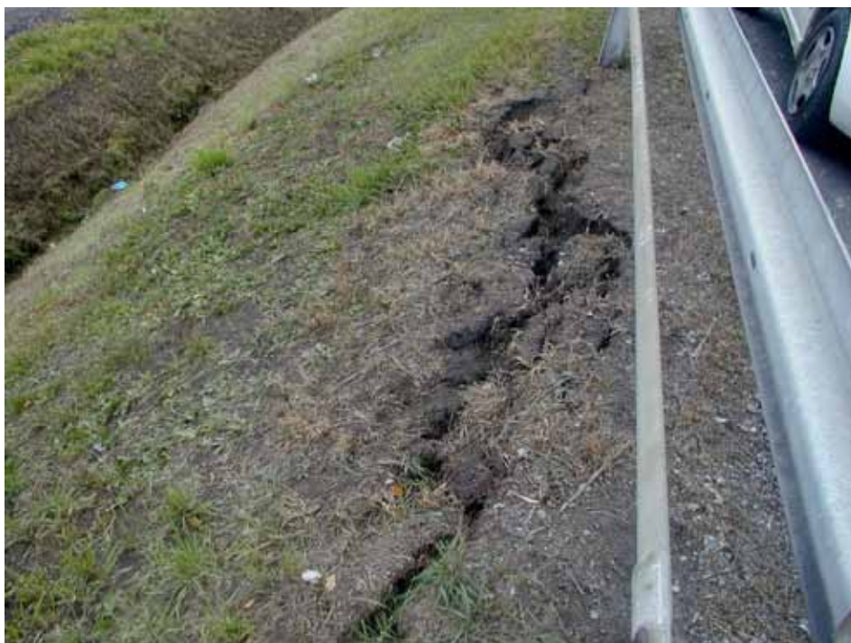
Fot. 18. Pęknięte południowe pobocze gruntowe po sezonie zimowym 2006/2007 na osuwisku „Mogilany III”
