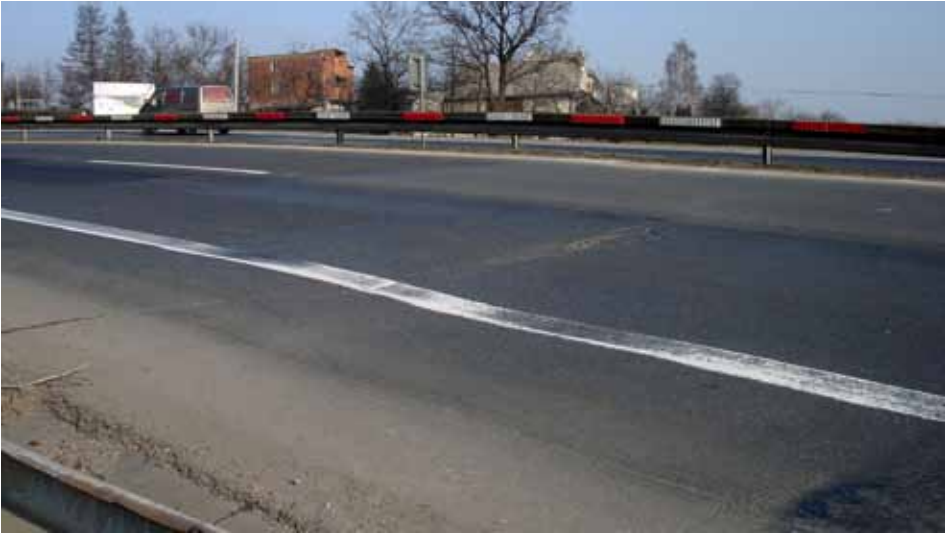
Fot. 20. Zdeformowana nawierzchnia na osuwisku „Mogilany III” (marzec 2007r.)
