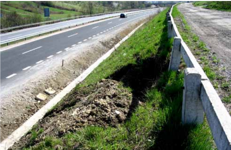
Fot. 33. Zsuw skarpy wykopu w m. Myślenice przy prawej jezdni DK 7 (kwiecień 2007r.)
