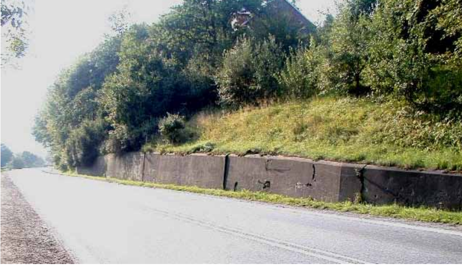
Fot. 2. Konstrukcja oporowa dla zatrzymania podciętego drogą zbocza góry; bloki na środku muru ulegają powolnym odchyleniom (duże parcie gruntu), co widoczne jest na podstawie cieni na stykach poszczególnych bloków. Km 703+500 – 703+650, strona prawa drogi, miejscowość Stróża
