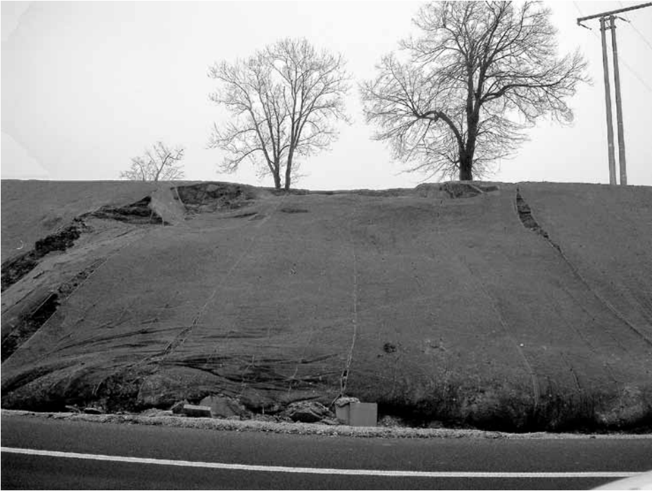
Fot. 2. DE S1, uszkodzenia skarp na obwodnicy Grodzca Śląskiego
