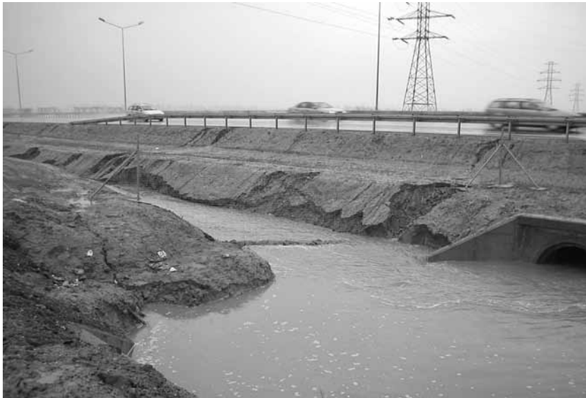
Fot. 11, 12. Podcięcia erozyjne - Autostrada A4
