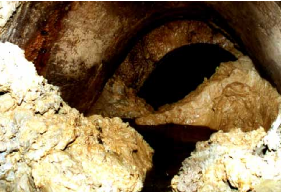
Fot. 23. Widok na przedostawanie się do wnętrza przepustu dużych ilości materiału z nasypu drogowego przez szczeliny w rozsuniętych kręgach
