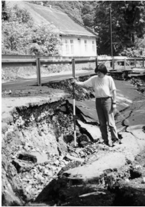
Fot. 1. Szosa zniszczona w wyniku osunięcia skarpy
