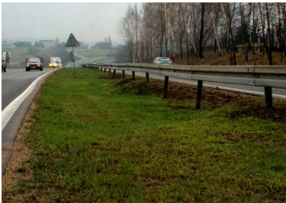
Fot. 30. Duże deformacje pasa rozdziła między jezdniami w m. Mogilany po sezonie zimowym 2003/2004 (marzec 2004r.)
