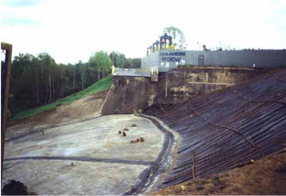
Fot. 1. Zniszczenie odcinka drogi krajowej nr 278 – wstępne zabezpieczenie ścian obszaru przyskarpowego i podnoża obsuniętego nasypu
