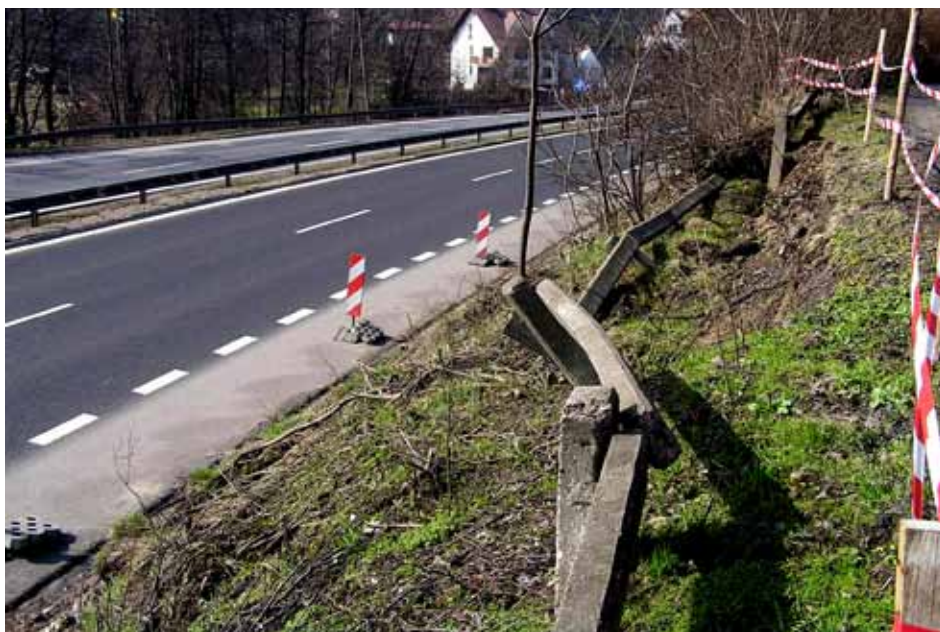
Fot. 26. Oberwanie się skarpy wykopu w m. Gaj, przy prawej jezdni DK 7 (kwiecień 2006r.)
