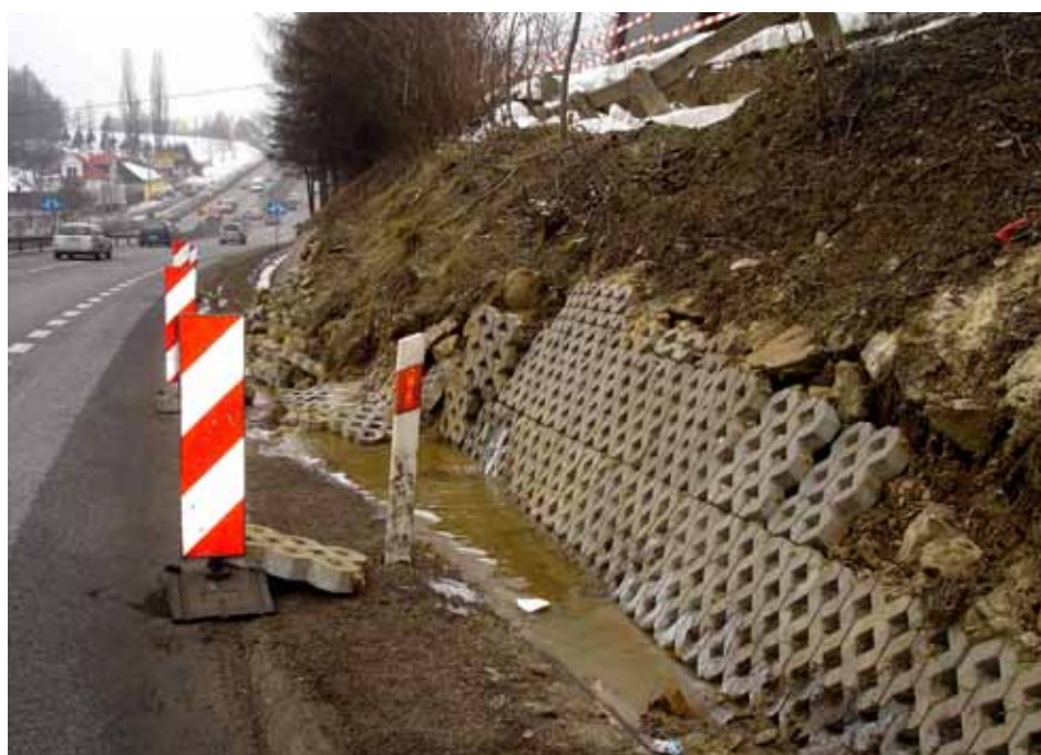
Fot. 27. Oberwanie się skarpy wykopu w m. Gaj, przy prawej jezdni DK 7 (kwiecień 2006r.)
