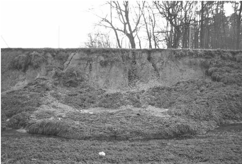
Fot. 5, 6. Spływy i spełzy - Autostrada A4
