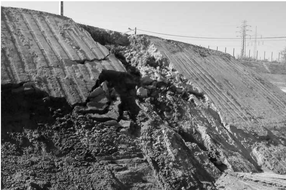
Rys. 5. Osunięcie (osuwisko?) we wcięciu drogi dojazdowej do autostrady A4 w rejonie ul. Bogucickiej w Krakowie w terenie bez naturalnych osuwisk (stan 20.04.2009). Fot. T. Mrozek
