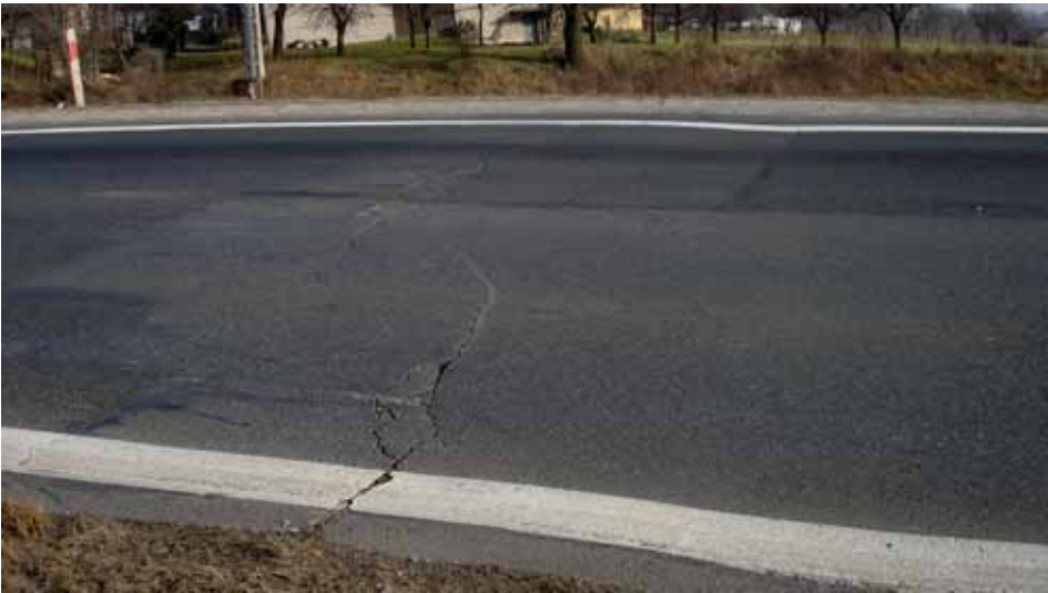
Fot. 21. Zdeformowana nawierzchnia na osuwisku „Mogilany III” (marzec 2007r.)
