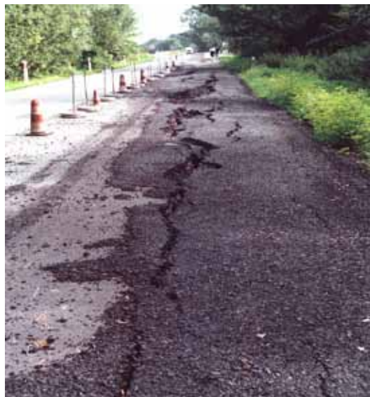
Fot. 4. Osuwisko na drodze krajowej nr 338 (Lubiąż - Kawice) – charakter zniszczeń konstrukcji nawierzchni
