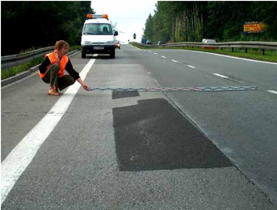
Fot. 8. Osuwisko nr 3 w Gaju, widoczne obniżenie niwelety nawierzchni lewej jezdni (stan przed ostatnią przebudową)
