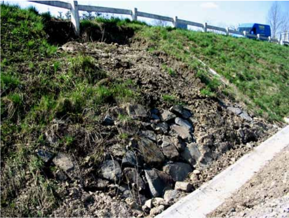
Fot. 34. Zsuw skarpy wykopu w m. Myślenice przy prawej jezdni DK 7, widoczna u podstawy skarpy przypora kamienna (kwiecień 2007r.)
