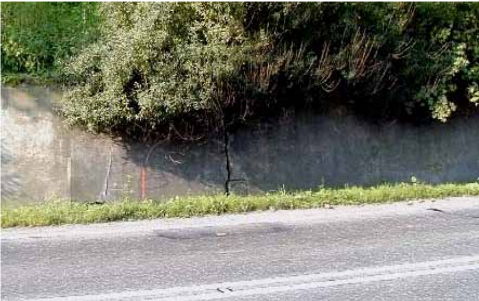
Fot. 3. Widoczne pęknięcie na czole muru (centrum zbocza, nad którym stoi budynek mieszkalny, dodatkowo go dociążając)
