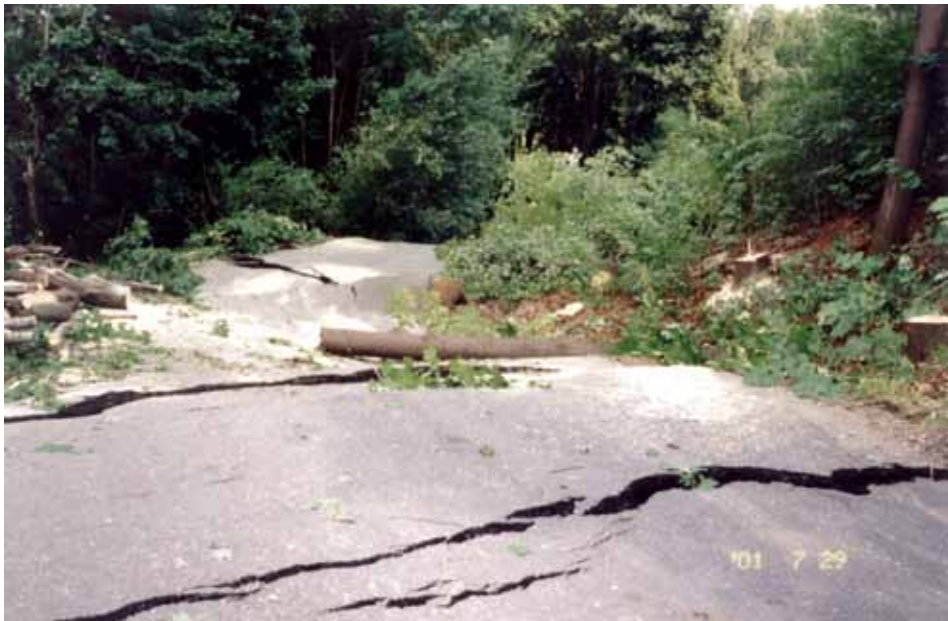
Fot. 2, 3. Widok zniszczeń pasa drogowego drogi wojewódzkiej nr 975 przez osuwisko w miejscowości Lipie
