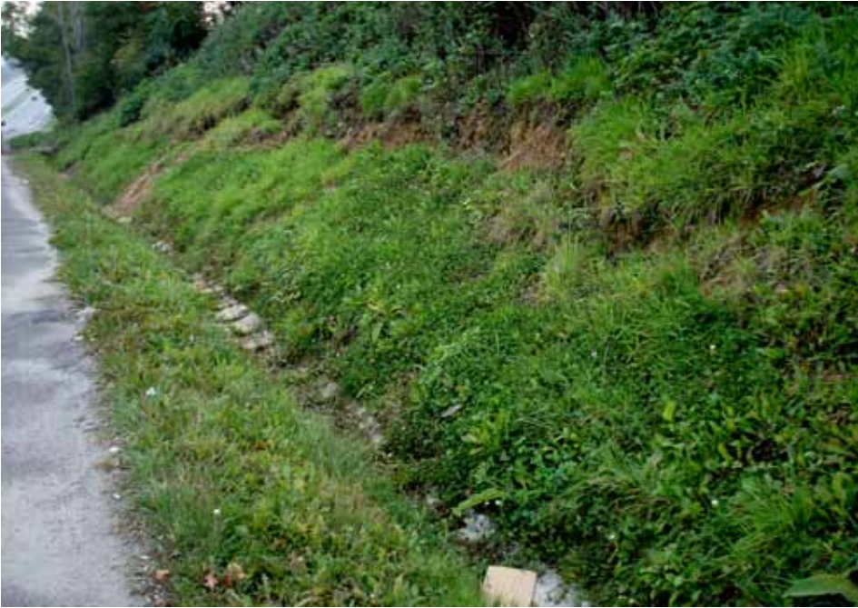
Fot. 28. Spływ powierzchniowy skarpy wykopu w m. Mogilany przy prawej jezdni DK 7 (październik 2007r.)
