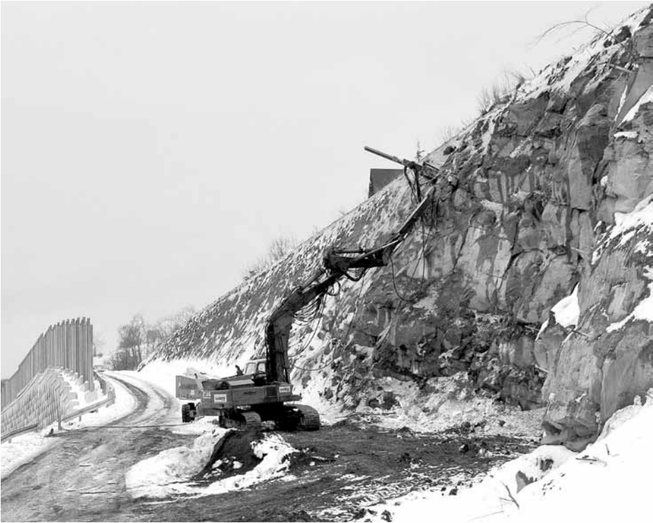
Fot. 7. DE S7, Lubień, widok na trzy różne typy konstrukcji gwoździowanych (ściana oporowa z licem żelbetowym, skarpa z oblicowaniem TECCO, kamieniołom w trakcie prac zabezpieczających)
