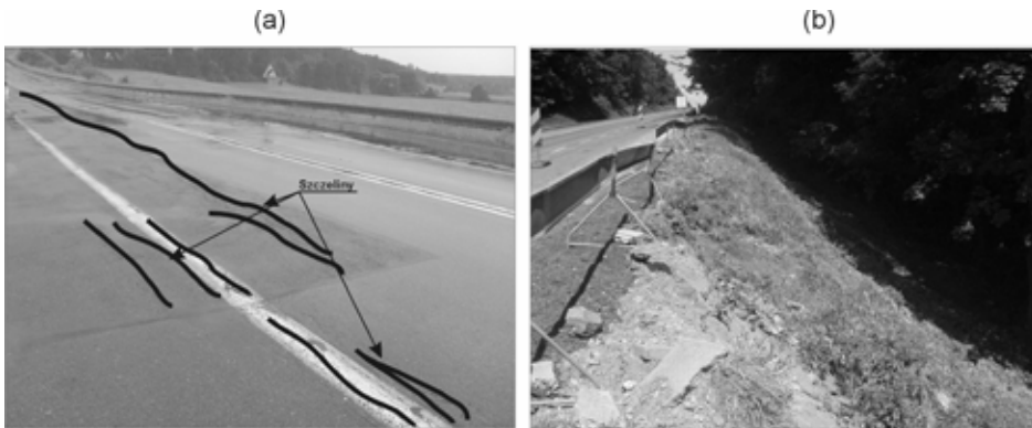
Fot. 3. Zniszczenia nasypu drogowego; (a) szczeliny w nawierzchni; (b) zsuw skarpy nasypu
