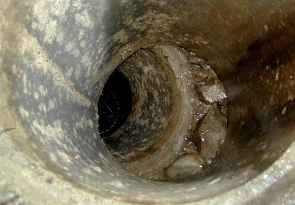
Fot. 13. Rozsunięte kręgi studni wpadowej do przepustu pod drogą; materiał z obsypki studni wpychany jest do studni
