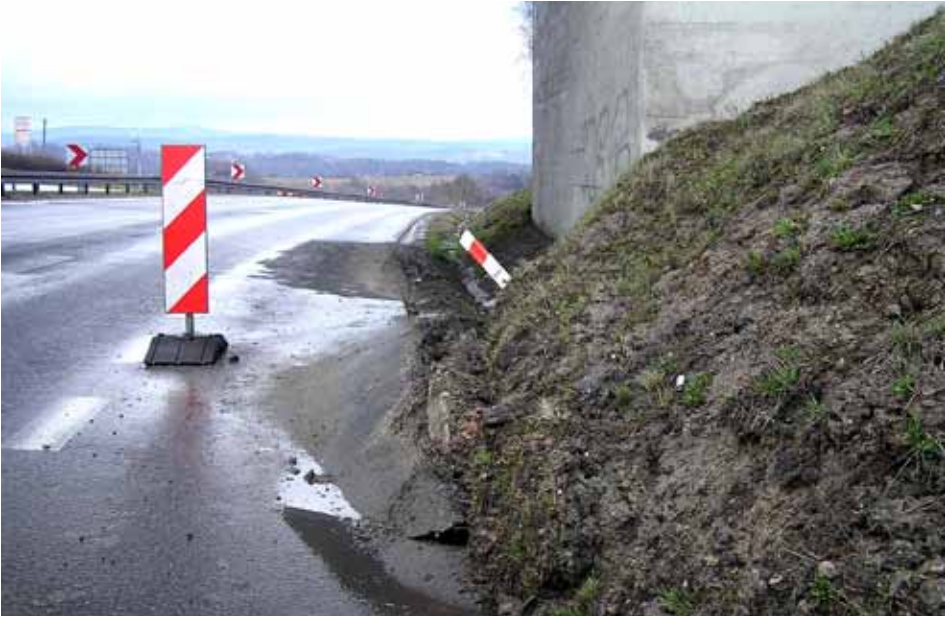
Fot. 32. Spływ stożka wiaduktu na węźle w Mogilanach przy prawej jezdni DK 7 (kwiecień 2006r.)
