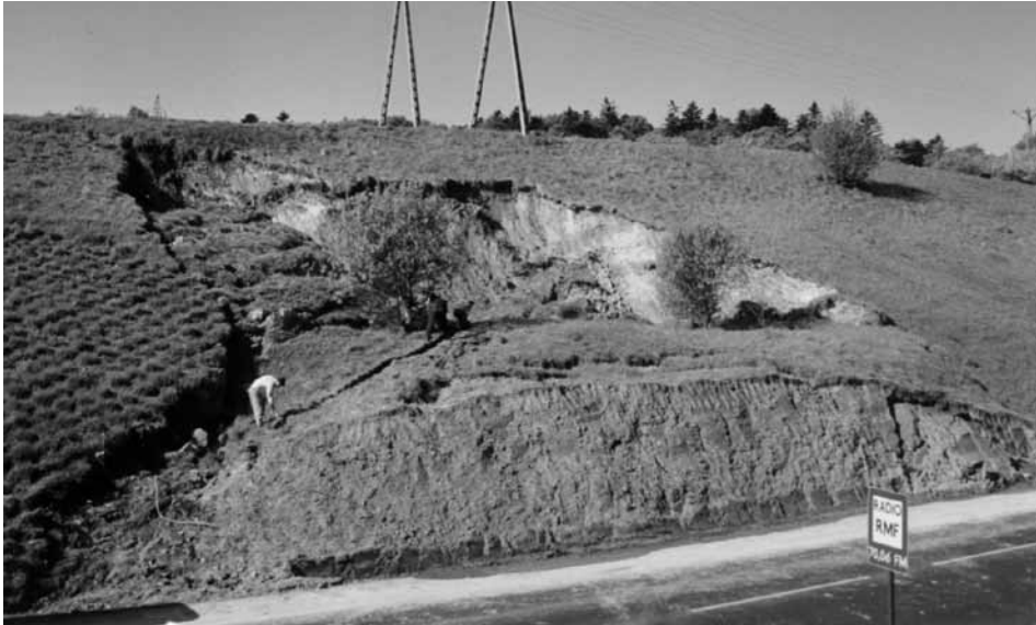
Rys. 4. Aktywizacja osuwiska przy obwodnicy E-40 koło Bochni. Wkop drogi przecina teren naturalnie podatny na osuwanie. Fot. B. Bąk
