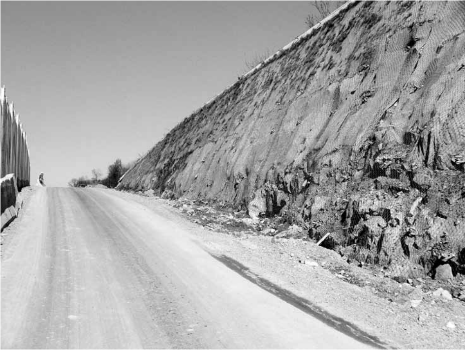
Fot. 6. DE S7, zabezpieczone skarpy w ciągu „Zakopianki”, obwodnica miejscowości Lubień. Skarpa przewidziana do hydroobsiewu
