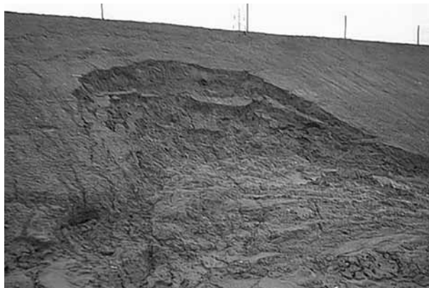
Fot. 3, 4. Wymycia filtracyjno-sufozujne - Autostrada A4
