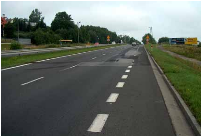
Fot. 15. Jezdnia lewa zdeformowana wciąż aktywnym dużym osuwiskiem, widoczne linie spękań i kolejne nakładki wyrównujące sfaldowania i garby
