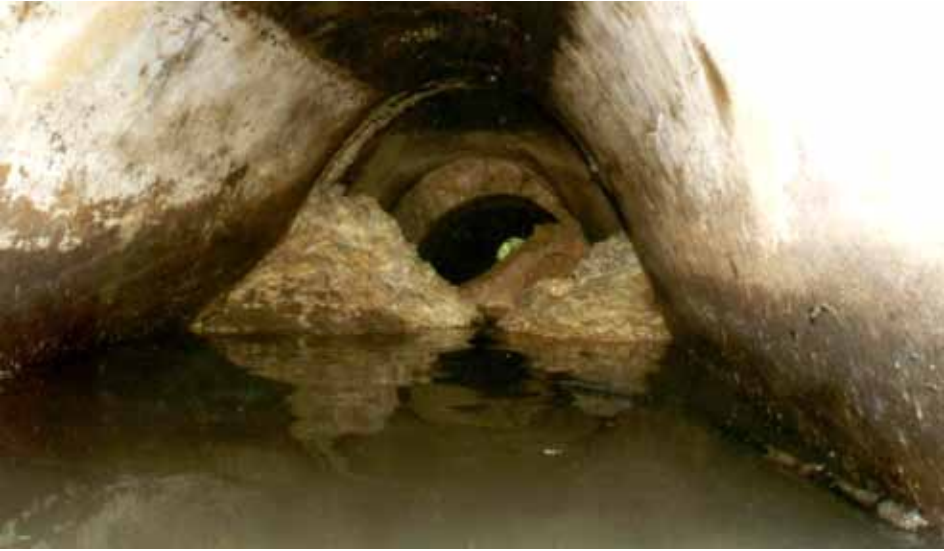
Fot. 22. Widoczne rozsunięcia poszczególnych elementów przepustu - zjawisko „klawiszowania”
