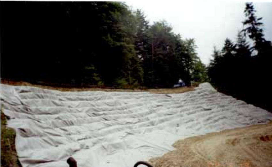
Fot. 1 Osuwisko w Bujnym w ciągu drogi wojewódzkiej nr 975: a) widok ogólny zniszczonego fragmentu drogi, b) prace przy zabezpieczeniu stoku i otwarciu korpusu drogi
