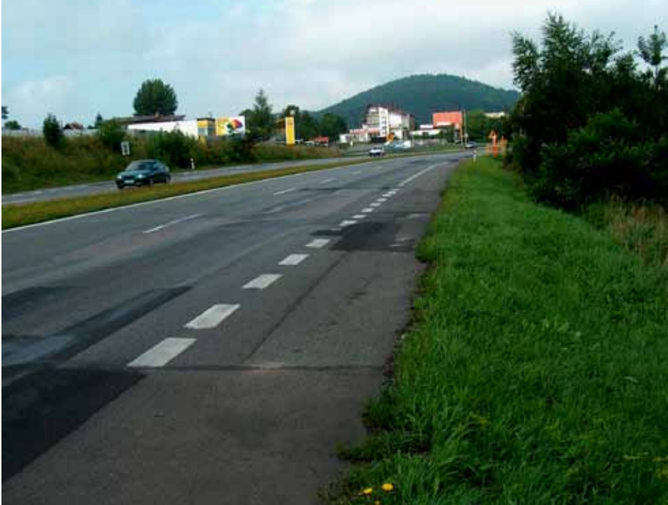
Fot. 24. Osuwisko nr 14 w Myślenicach, widok na zdeformowaną nawierzchnię lewej jezdni, widoczne wyraźne pochYLENIA młodych drzew poniżej skarpy nasypu rosnących w linii osuwiska
